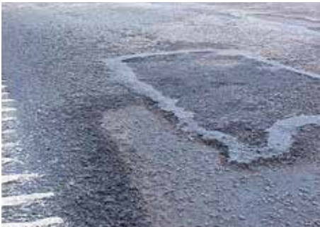
Rafeling is een oppervlakkige degradatie van het wegdek
