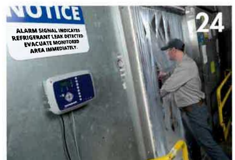
Vaste lekkdetectiesystemen onder de loep
