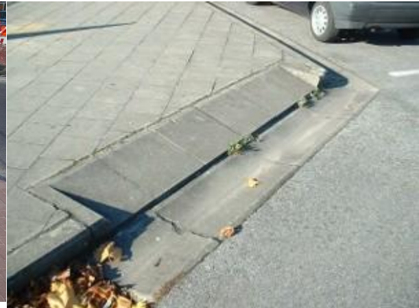
Traversée piétonne inaccessible : filet d'eau en demi-lune avec ressaut + bordure trop pentue (« bateau d'accès »)
