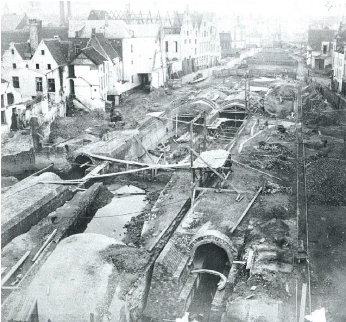
Figure 6 : Chantier de voutement entre la rue des Teinturiers et la rue des Pierres, juillet 1870 – source : coordination Senne asbl
