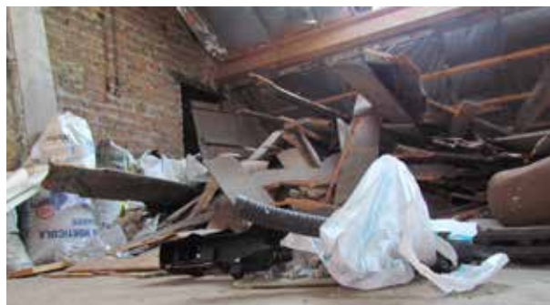
Empoussièremment pouvant contaminer le logement
