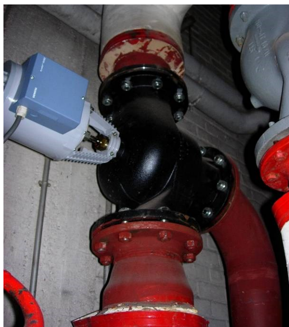
Figure 3.11: Vanne motorisée de régulation à 3 voies
