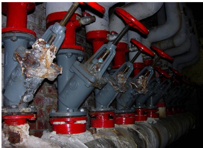
Figure 3.9: Vannes d'isolement à soupape à siège incliné (à calorifuger et à réparer)
