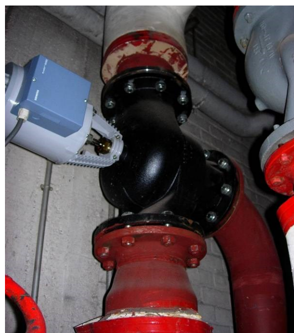
Figure 3.11: Vanne motorisée de régulation à 3 voies
