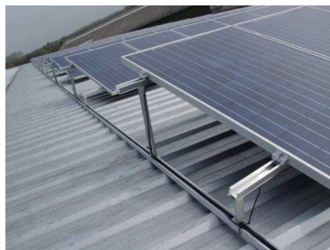
Figure 4: Capteurs solaires PV dont la structure portante en métal est fixée à la structure du bâtiment. Limburgse Tuinbouwveiling, Herk-de-Stad. (3E)
