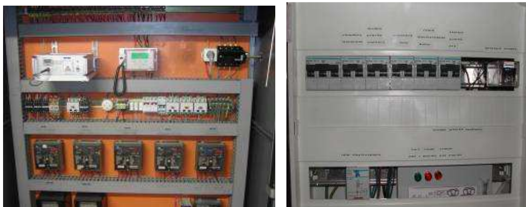
Foto's 11 en 12 : Controlebord en zekeringenkast
