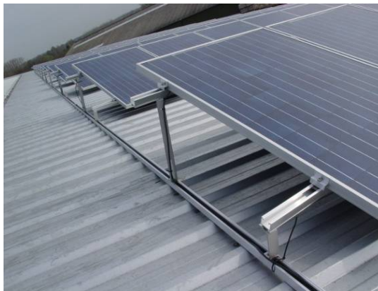
Figuur 3 : Fotovoltaïsche zonnepanelen gemonteerd op een metalen draagstructuur die is verankerd op het dak (Project Limburgse Tuinbouwveiling, Herk-de-Stad)
