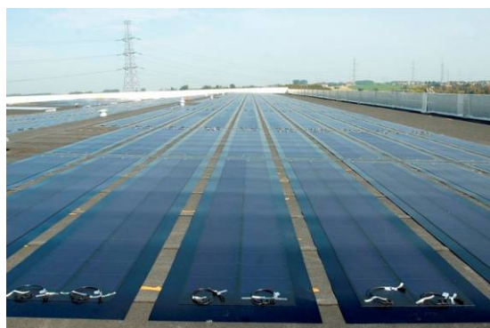
Figuur 4 : Zonnesysteem met soepele amorfe siliciumpanelen die zijn gekleefd op het waterdichte membraan van de dakbedekking (Project Colruyt, Halle. [Foto Colruyt])
