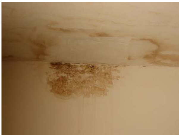
Les fuites provoquent des problèmes d'humidité très localisés (Photo VIBE asbl)
