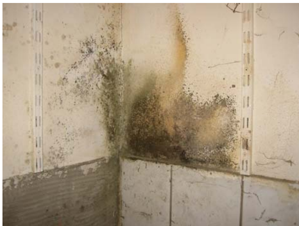
Trop d'humidité ? Les moisissures apparaissent ! A fortiori dans les anciens bâtiments. (Photo VIBE asbl)
