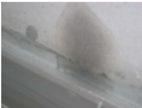
Auréoles d'humidité à la base du mur : humidité ascensionnelle (photo : VIBE asbl)
