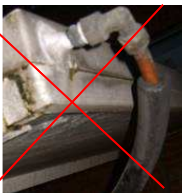
Figure 3. absence d'isolation au niveau des raccords entre capteurs
