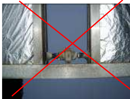
Figure 2. absence d'isolation au niveau des coudes
