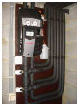
Figure 4. isolation parfaitement continue aux normes actuelles ; les tuyaux sont invisibles
