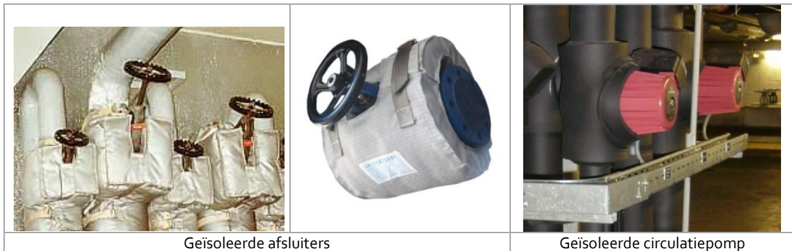
Afbeelding 42 – Volledige isolatie van afsluiters en pompen
