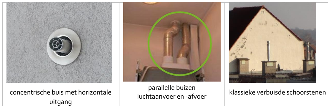
Afbeelding 13 – Modellen voor de afvoer van verbrandingsgassen van een verwarmingsketel van het gesloten type
