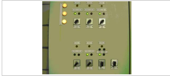
Afbeelding 47 – Elektrische regelborden van de circulatiepompen
