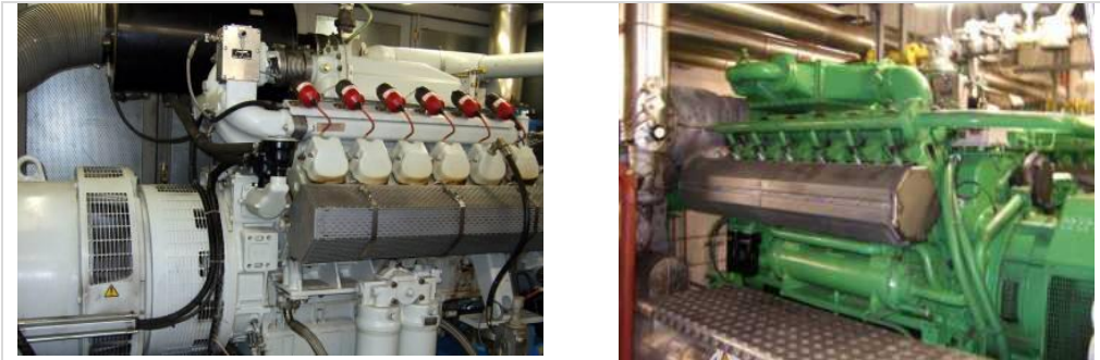
Afbeelding 22 – De cilinderkoppen van een warmtekrachtkoppeling
