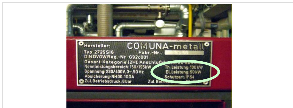
Afbeelding 32 – Kenplaat van een warmtekrachtkoppeling en elektrisch vermogen
