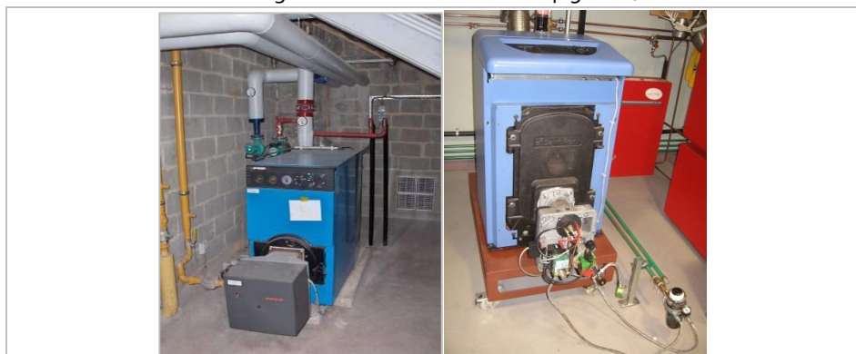
Afbeelding 11 – Verwarmingsketels met een ventilatorbrander
