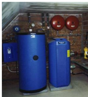
Afbeelding 6o – Collectieve installatie met voorraadvaten
