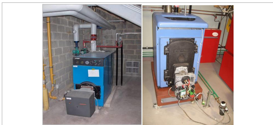
Illustration 11 – Chaudières avec un brûleur à gaz pulsé
