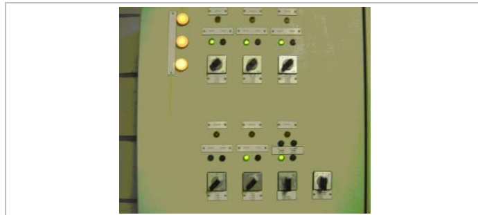
Illustration 47 – Tableau électrique de régulation des circulateurs
