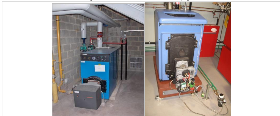
Afbeelding 11 – Verwarmingsketels met een ventilatorbrander
