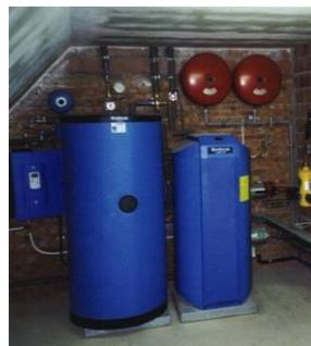
Afbeelding 61 – Collectieve installatie met voorraadvaten
