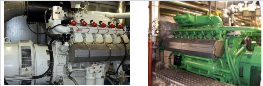
Afbeelding 22 – De cilinderkoppen van een warmtekrachtkoppeling
