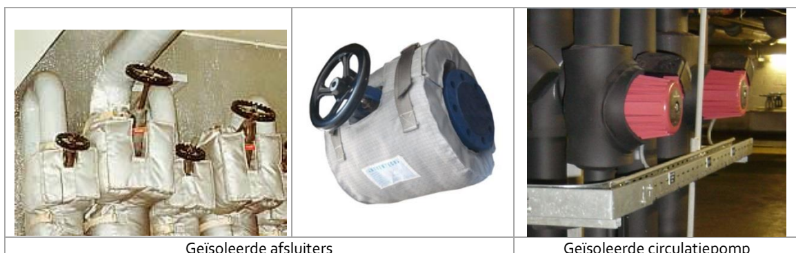
Afbeelding 43 – Volledige isolatie van afsluiters en pompen
