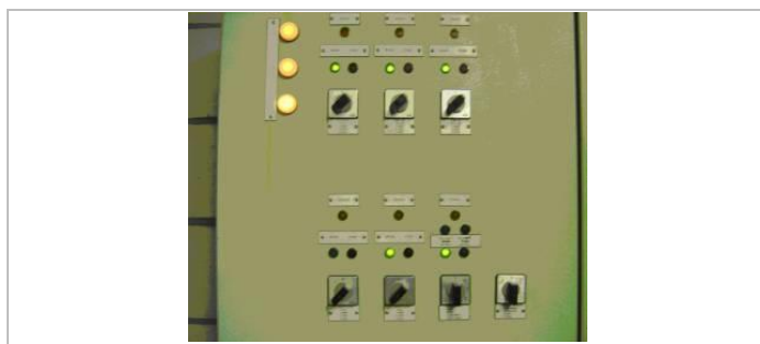
Afbeelding 48 – Elektrische regelborden van de circulatiepompen
