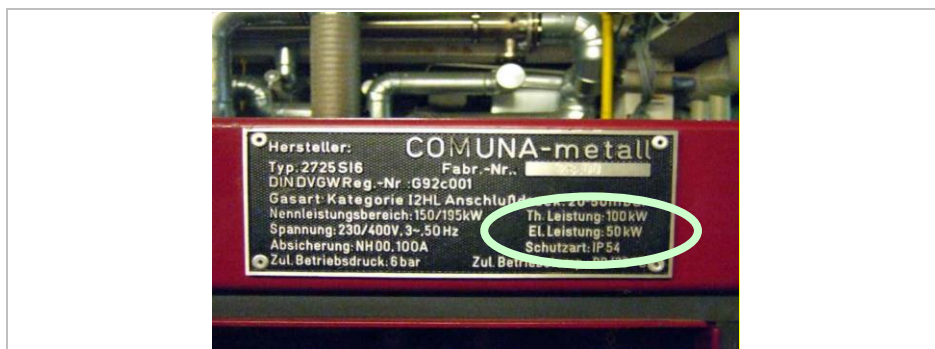
Afbeelding 32 – Kenplaat van een warmtekrachtkoppeling en elektrisch vermogen
