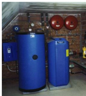
Illustration 61 – Installation collective avec des ballons de stockage
