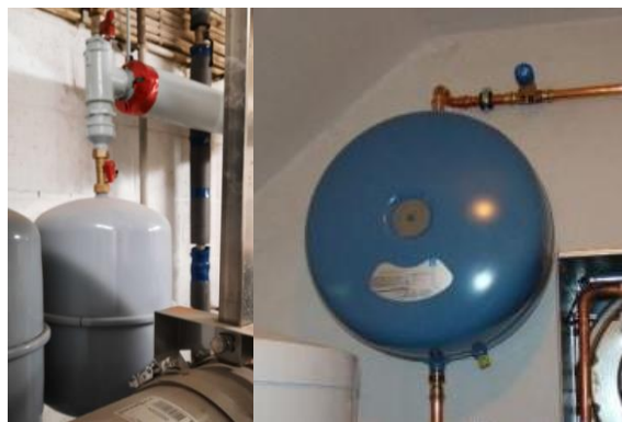
Illustration 63 – Vases d'expansion reliés au circuit d'ECS en un point (gauche) et en ligne (droite)
