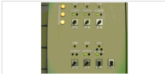
Illustration 48 – Tableau électrique de régulation des circulateurs
