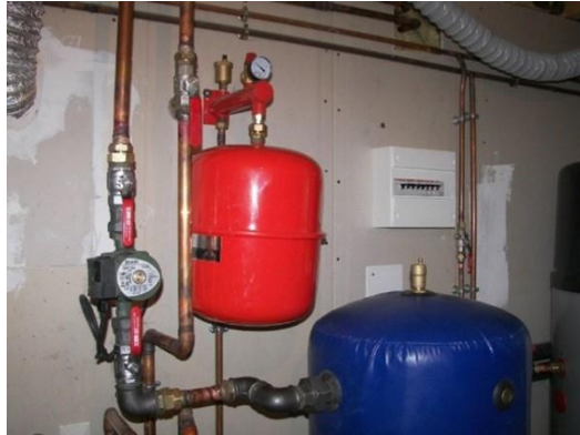
Illustration 36 – Vase d'expansion relié au circuit de chauffage
