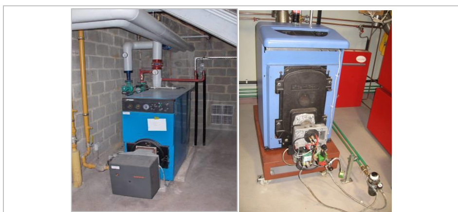
Illustration 11 – Chaudières avec un brûleur à gaz pulsé
