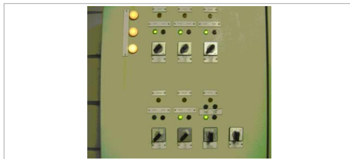
Illustration 48 – Tableau électrique de régulation des circulateurs
