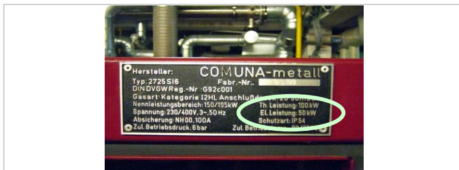
Illustration 32 – Plaque signalétique d'une cogénération et puissance électrique
