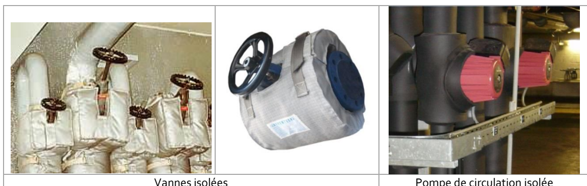
Illustration 43 – Isolation complète de vannes et de pompes
