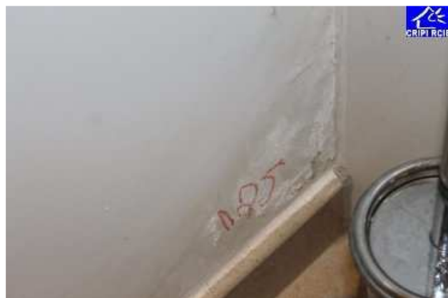
Foto 5: zichtbare vochtoppervlakken (Bron RCIB)
