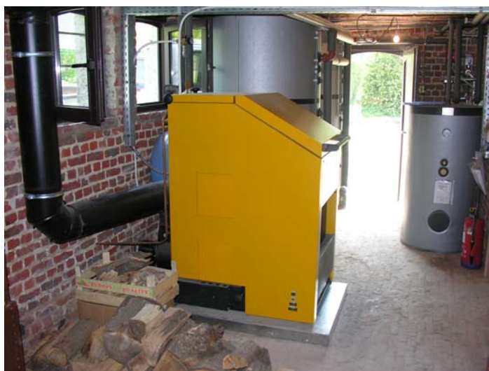
Chaudière à bûches (45 kW), maison forestière de la Drève des Bonniers (Watermael Boitsfort)
