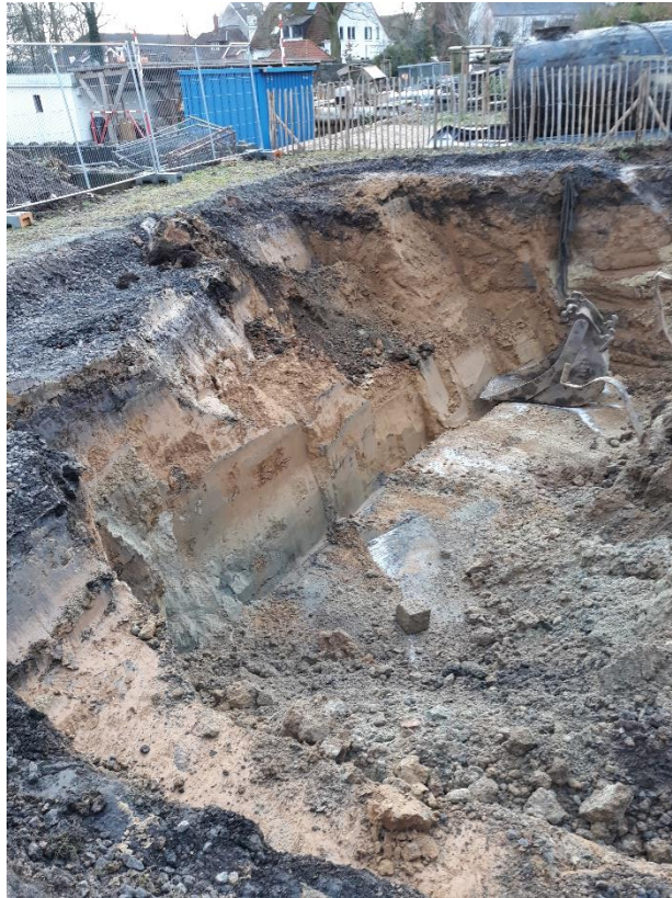
Photo 3 : paroi Est de la fosse avec présence de signes de pollution visibles (gris-vert) à la profondeur de la dalle
